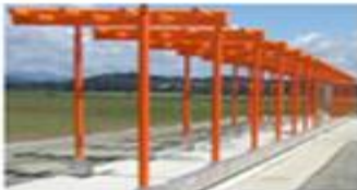
1. Localizer Antenna Array (Erwan, 2017)
